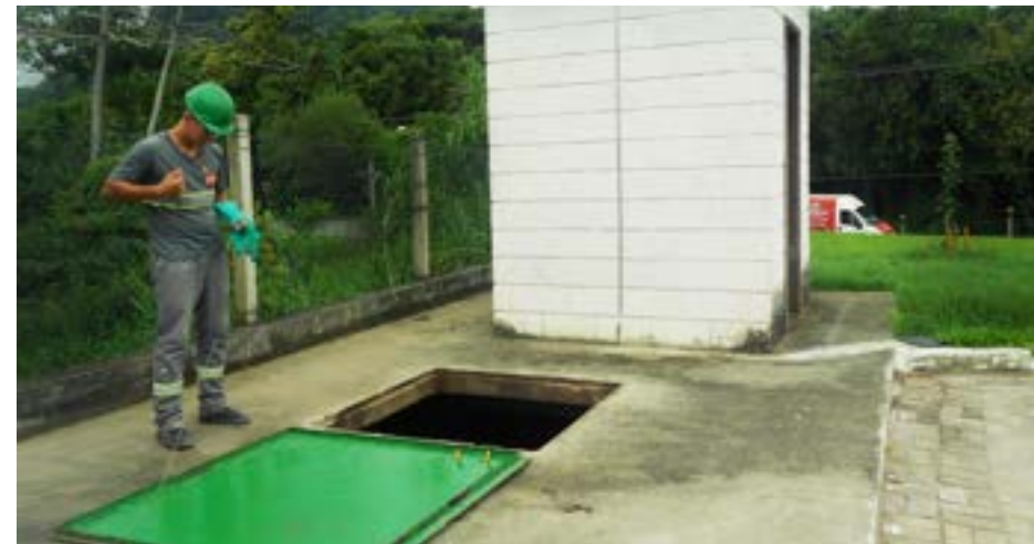
Tratamento Efluentes - Unidade Misturadora São Francisco do Sul-SC
